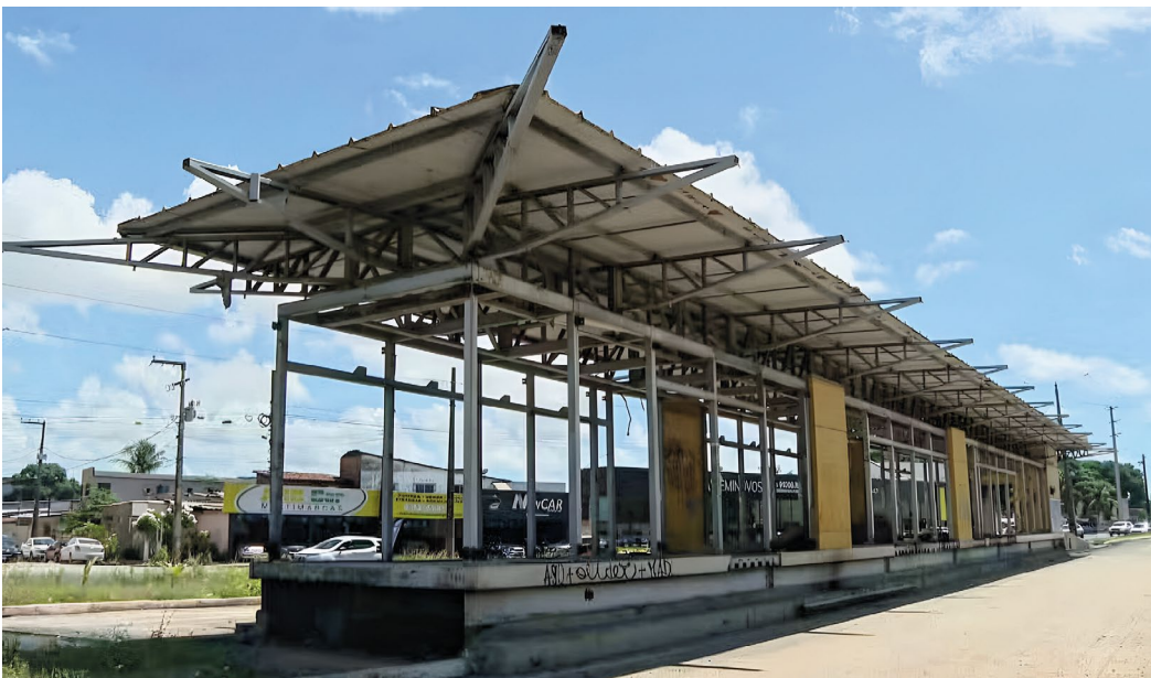
Estação de BRT abandonada na Região Metropolitana do Recife. / Crédito: Yara Baiardi.
