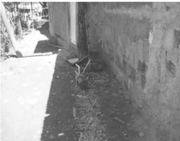
Foto 7 – Instalações precárias: bomba d'água instalada por morador para recalcar água para sua caixa d'água.
