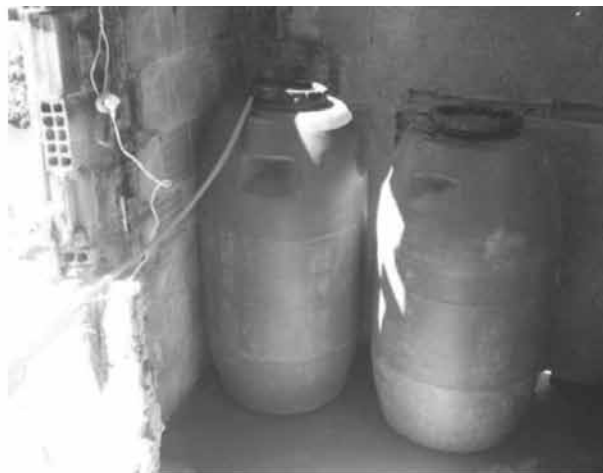
Foto 8 – Improvise: galões são usados como reservatório intermediário
